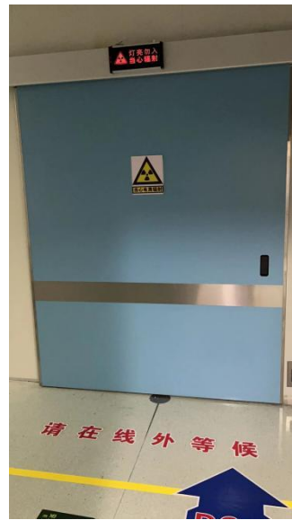
DSA 机房受检者防护门警示灯、电离辐射标志
